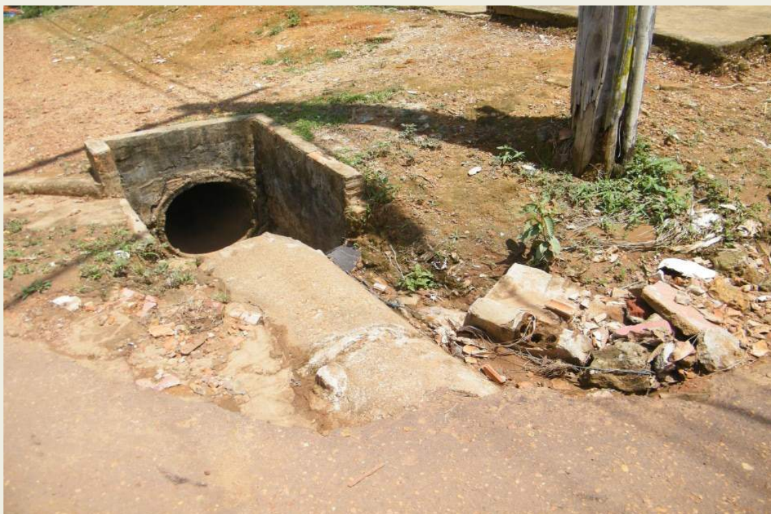
ILUSTRAÇÃO 4.1.3.2: TUBULAÇÃO DE ÁGUAS PLUVIAIS DESEMBOCANDO NUMA BOCA DE LOBO.
