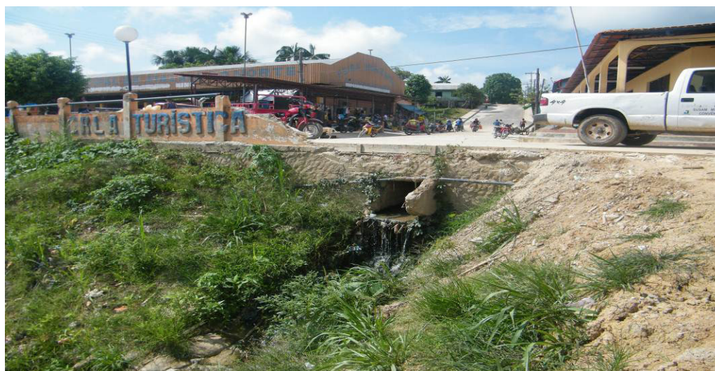
ILUSTRAÇÃO 4.1.2.3 – LANÇAMENTOS DE ÁGUAS PLUVIAIS EM ATALAIA DO NORTE.
