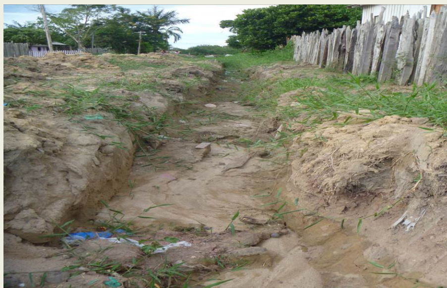
ILUSTRAÇÃO 4.1.2.2 FALTA DE DRENAGEM NO MUNICÍPIO.
