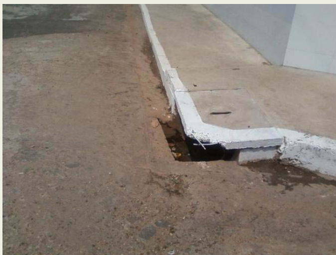
ILUSTRAÇÃO 4.1.2.2 - VISTA DO ESTADO DA BOCA DE LOBO NO PERÍMETRO URBANO DE CAAPIRANGA/AM. FOTO: PLAMSAN.
