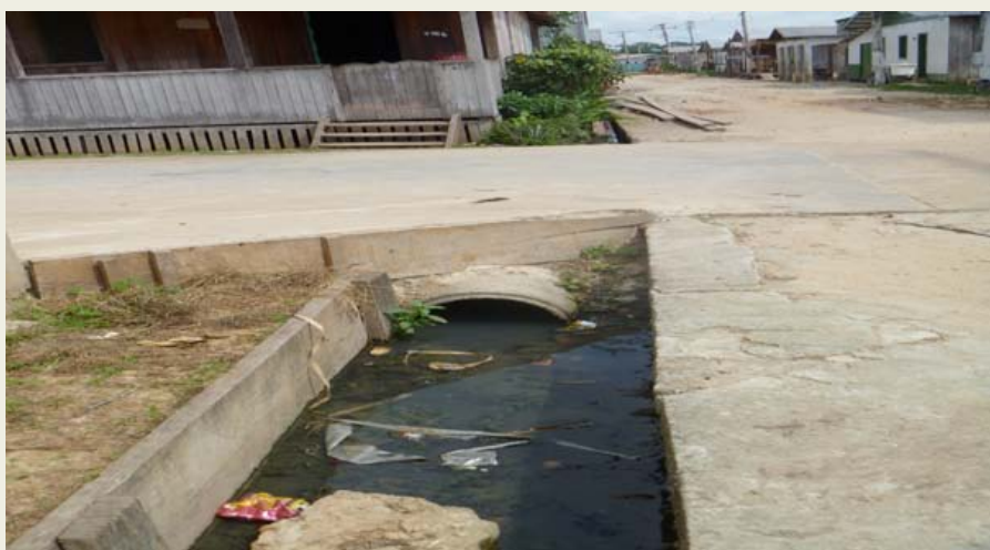
ILUSTRAÇÃO 4.1.2.2 – TUBULAÇÃO DE ÁGUAS PLUVIAIS
