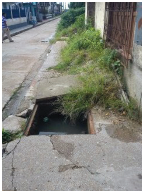
ILUSTRAÇÃO 4.1.2.1 – BOCA DE LOBO SEM A DEVIDA TAMPA NO PERIMETRO URBANO DO MUNICÍPIO DO CAREIRO DA VÁRZEA
