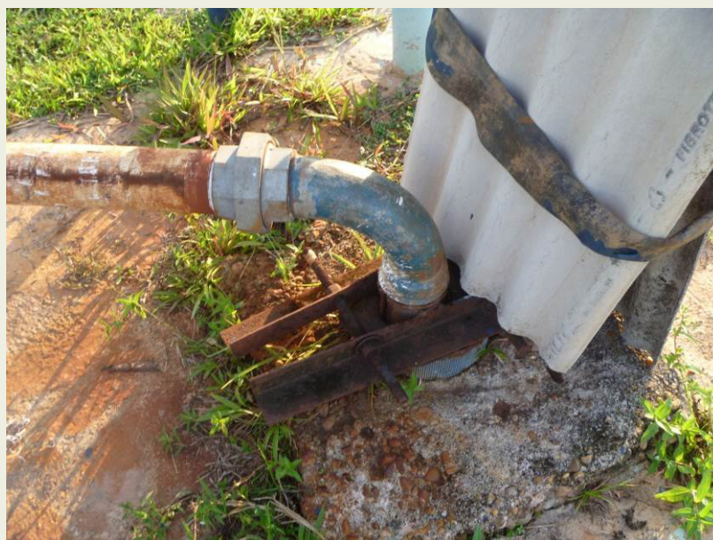
ILUSTRAÇÃO 4.1.2.1: EXEMPLO DE POÇO NA SEDE DO CAREIRO.
