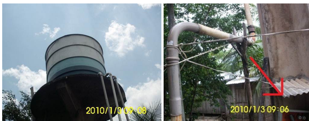
ILUSTRAÇÃO 4.1.2.4: ESTRUTURA DE ABASTECIMENTO DE ÁGUA DA COMUNIDADE DE TILHEIRO – CAREIRO/AM. FOTO: PLAMSAN.
