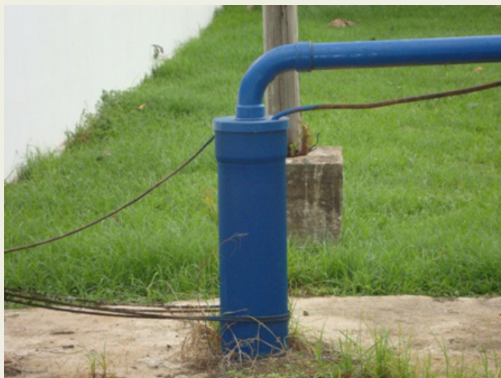
ILUSTRAÇÃO 4.1.2.2: POÇO TUBULAR ENCAMISADO SEDE COSAMA.
