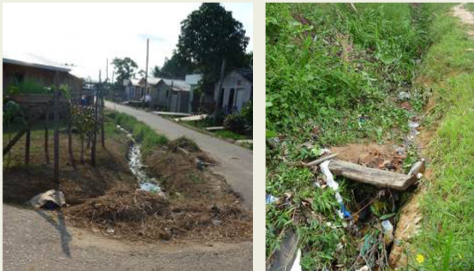
ILUSTRAÇÃO 4.1.2.5: SISTEMAS DE DRENAGEM PRECÁRIOS EM EIRUNEPÉ.
