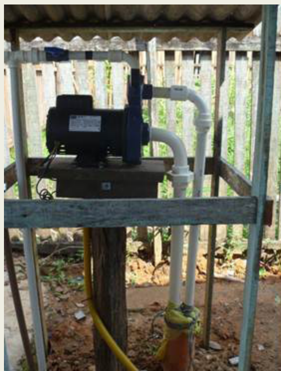
ILUSTRAÇÃO 4.1.2.3: POÇO COMUNITÁRIO NOVO.
