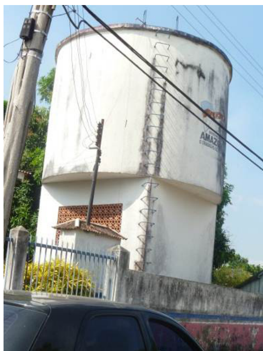
ILUSTRAÇÃO 4.1.2.3 - RESERVATÓRIO EM FUNCIONAMENTO EM ITAPIRANGA/AM.
