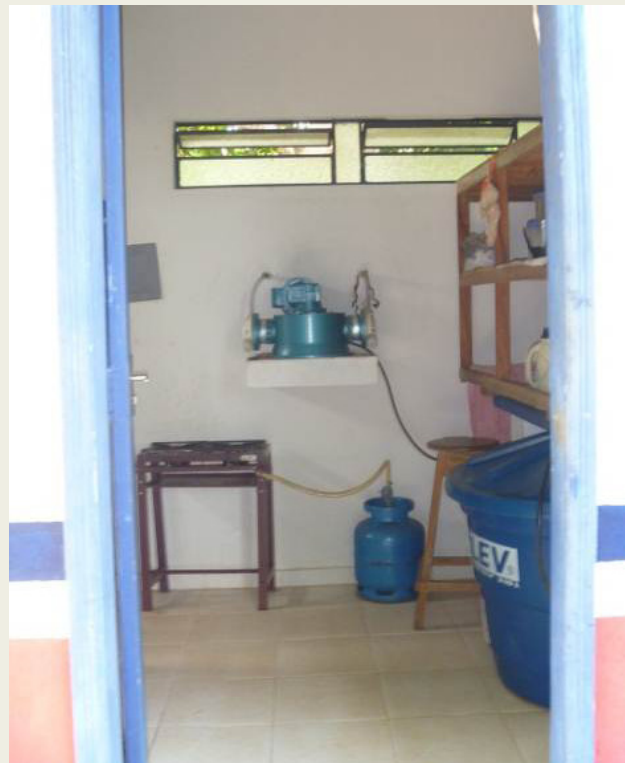
ILUSTRAÇÃO 4.1.2.2 - DOSADORES E TANQUES PARA A CLORAÇÃO NO MUNICÍPIO DE ITAPIRANGA.
