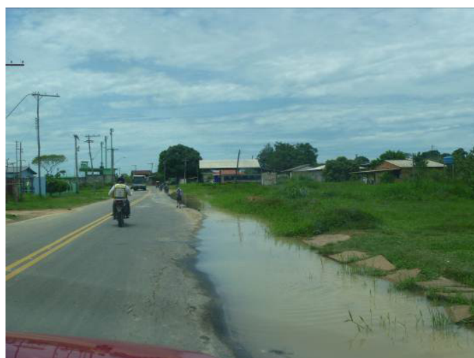
ILUSTRAÇÃO 2.6.6 – RUA ASFALTADA SEM GUIAS E SARJETAS - ALAGADAS NAS LATERAIS.
