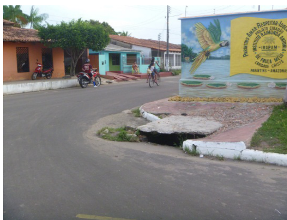
ILUSTRAÇÃO 4.1.2.2 – BOCA-DE-LOBO DE GUIA COM DEPRESSÃO EM VIA PÚBLICA EM PARINTINS/AM
