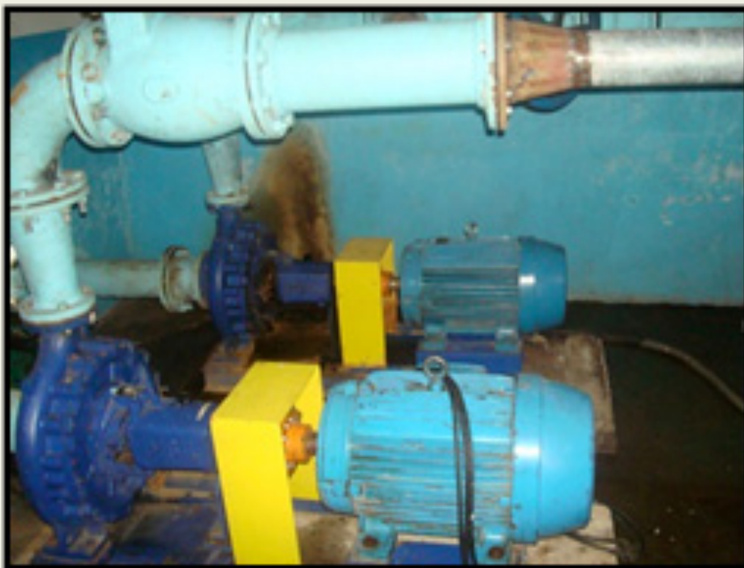
ILUSTRAÇÃO 4.1.2.2 - CONJUNTO MOTOR-BOMBA DA CAPTAÇÃO SUPERFICIAL
