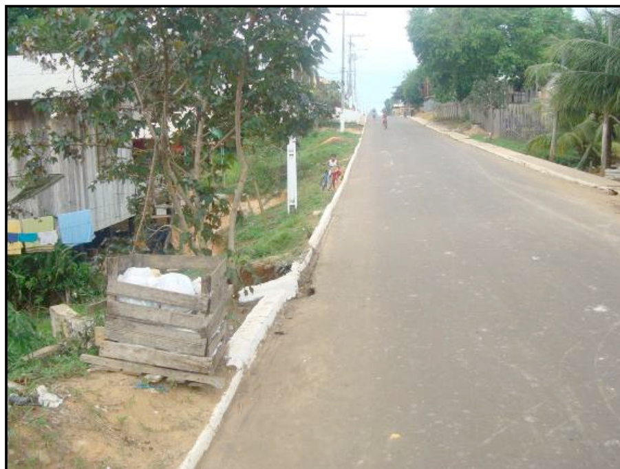
ILUSTRAÇÃO 4.2.3.5 - CAIXA COLETORA EM PÉSSIMAS CONDIÇÕES DE USO EM BAIRRO
