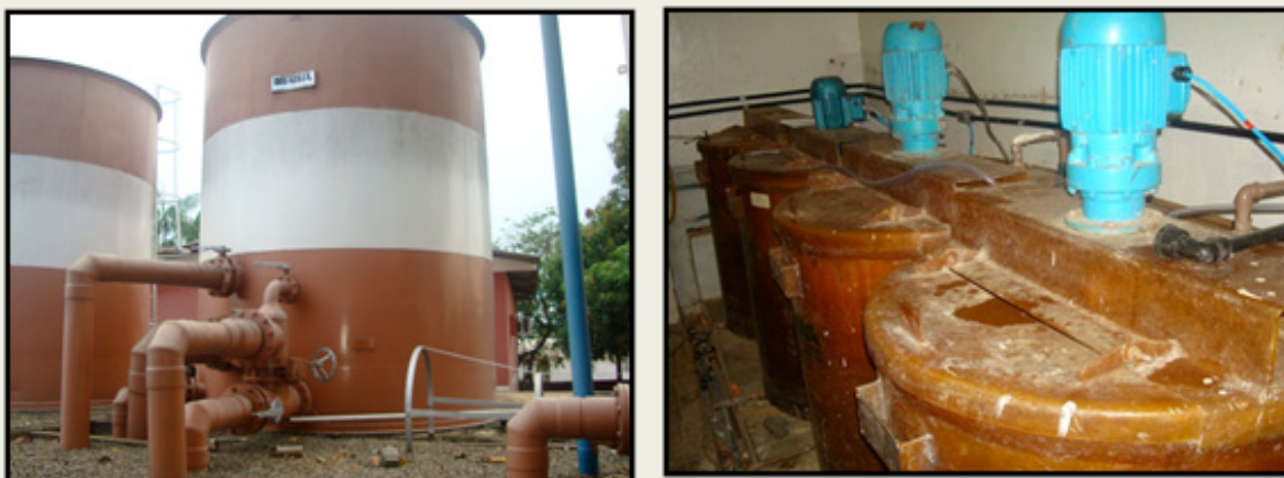
ILUSTRAÇÃO 4.1.2.5 – ESTAÇÃO DE TRATAMENTO DE ÁGUA
