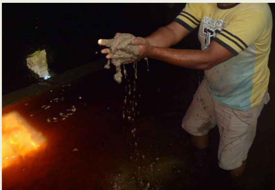
ILUSTRAÇÃO 4.1.2.3: RESERVATÓRIO APOIADO COM ACÚMULO DE SEDIMENTOS
