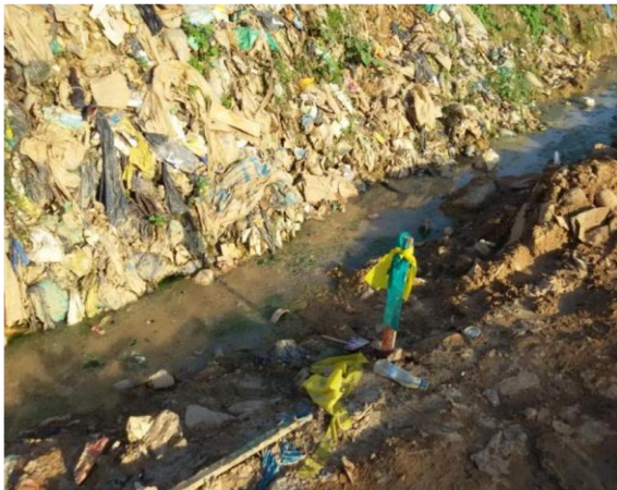
o) Acúmulo de água pluvial
