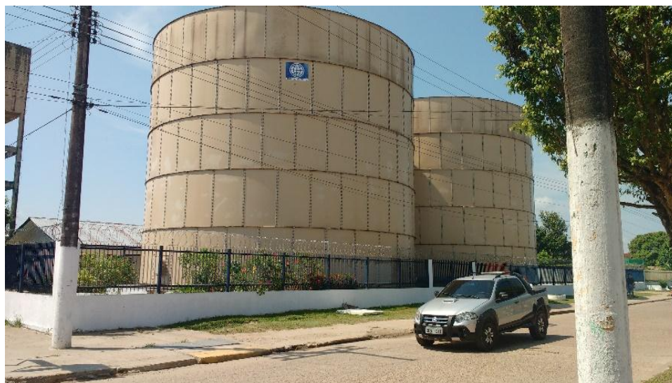
Figura 9: Reservatórios Bairro Centro localizados na Av. da Amizade.
