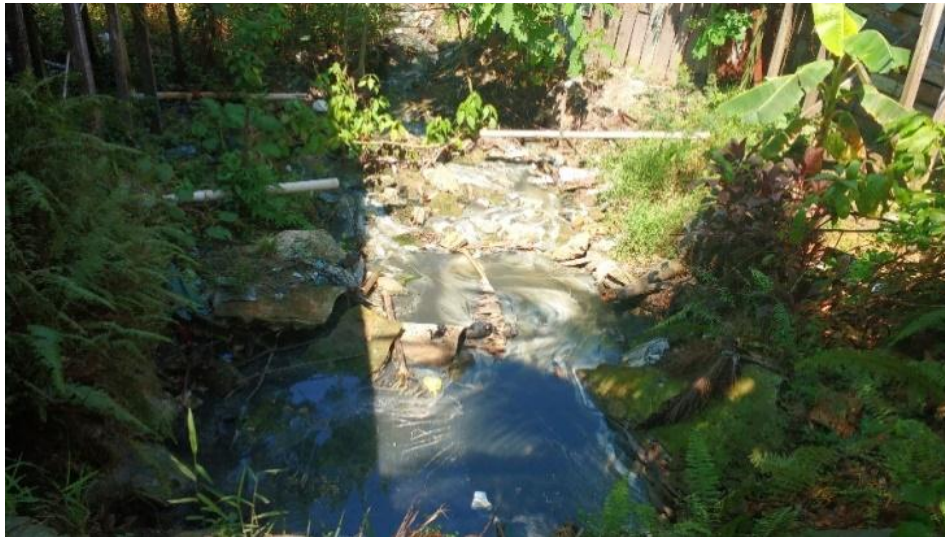
Figura 11: Instalações inadequadas no Bairro Brilhante – Rua 13 de Maio. Fonte: SEMMAT, 2017.
